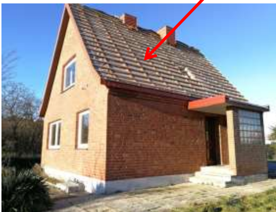
Foto 19: Wohnhaus Sundweg 101 Südostseite, Dachziegel abgedeckt (Pfeil) mit Öffnungen (Lage s. Abb. 4: Gebäude 101)
