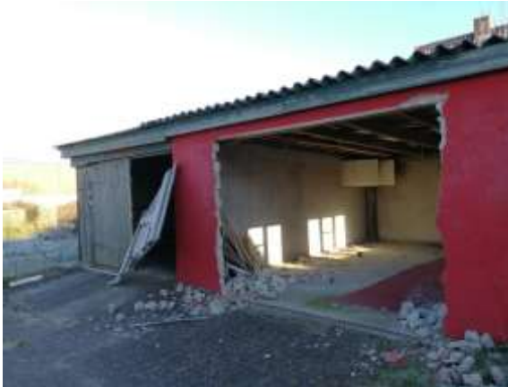
Foto 17: Schadhafte Gebäude auf dem Grundstück Sundweg 103, Westseite (Lage s. Foto 16)
