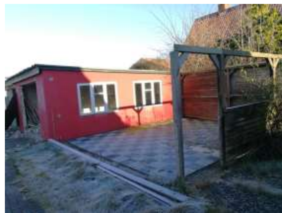
Foto 16: Schadhafte Gebäude auf dem Grundstück Sundweg 103, Südwestseite (Lage s. Abb. 4: Gebäude 103a)
