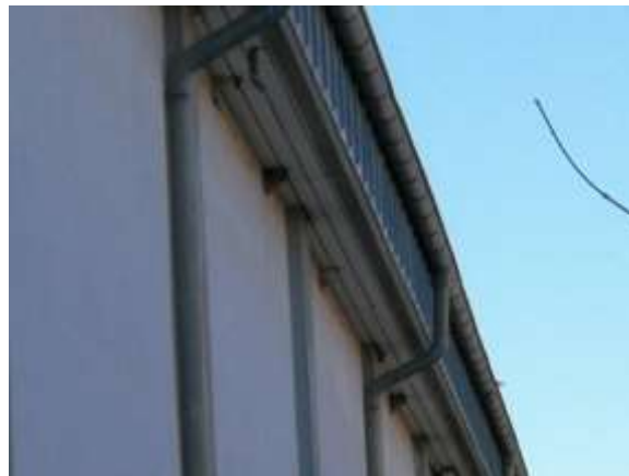
Foto 2: Rückseite des bestehenden Lidl-Verkaufsgebäudes, (Norden) mit z.T. defekten Mehlschwalbennestern (Lage s. Foto 1)
