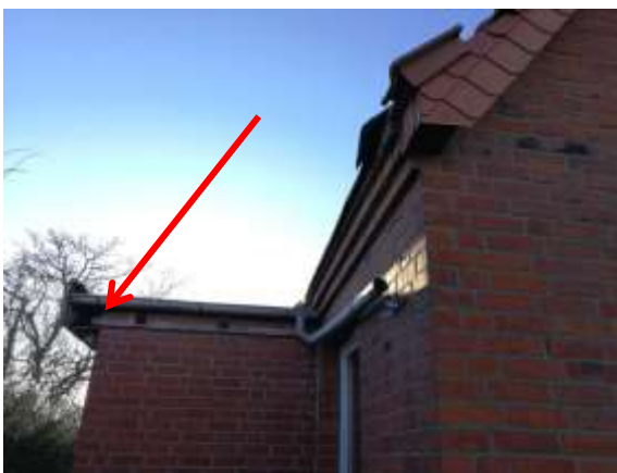
Foto 15: Wohnhaus Sundweg 103 Südostseite, Detail mit Spaltenstrukturen an defekten Dachabschlüssen (Pfeil), (Lage s. Foto 16)
