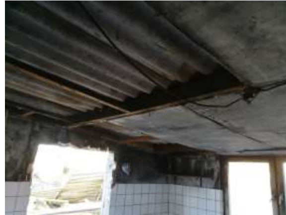
Foto 12: Schadhafte Gebäude auf dem Grundstück Sundweg 105, Innenraum mit Brand- oder Räucherspuren (Lage s. Foto 11)
