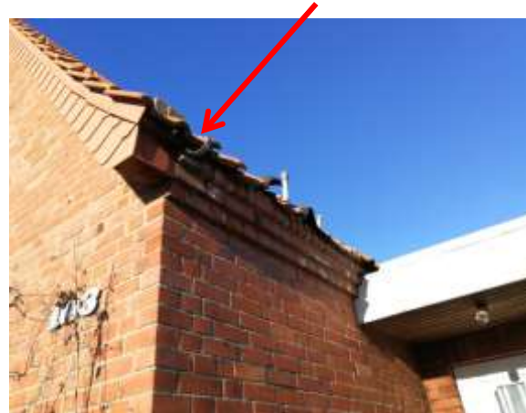
Foto 14: Wohnhaus Sundweg 103 Südostseite, Detail mit Spaltenstrukturen an defekten Dachabschlüssen (Pfeil), (Lage s. Abb. 4: Gebäude 103)
