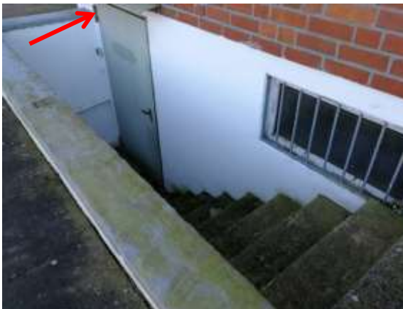
Foto 7: Wohnhaus Sundweg 105, Nordseite mit Kellereingang, oben sehr schmaler Spalt an der Tür (Pfeil), (Lage s. Foto 4)
