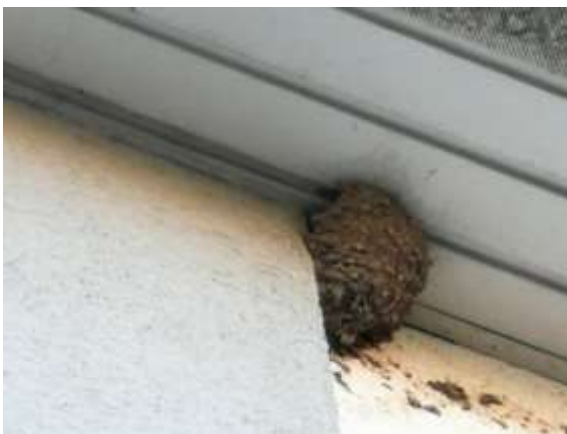
Foto 3: Mehlschwalbennest auf der Rückseite des bestehenden Lidl-Verkaufsgebäudes (Detail aus Foto 2)
