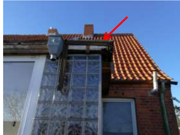
Foto 6: Wohnhaus Sundweg 105, Ostseite, Detail mit Spaltenstrukturen an defekten Dachabschlüssen (Pfeil), (Lage s. Foto 4)
