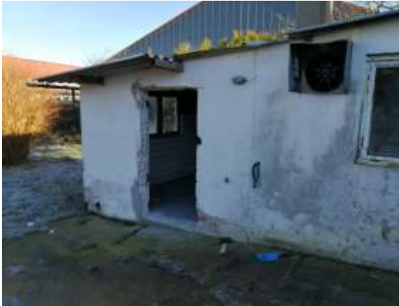
Foto 11: Schadhafte Gebäude auf dem Grundstück Sundweg 105, Westseite (Lage s. Abb. 4: Gebäude 105a)
