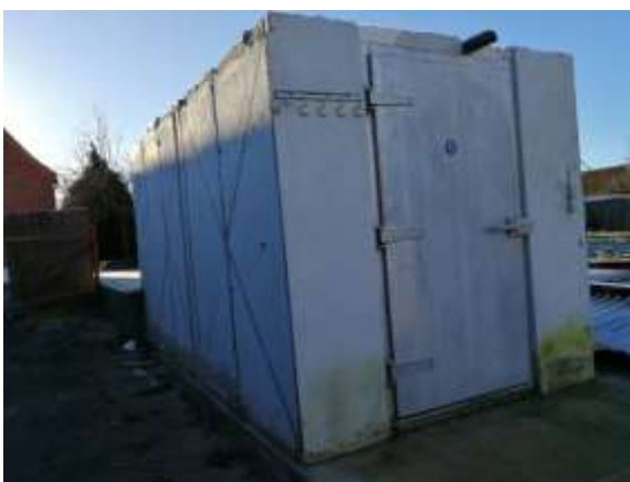
Foto 9: Schadhafes containerartiges Gebäude (ehemaliger Kühlraum?) auf dem Grundstück Sundweg 105 (Lage s. Abb. 4: Gebäude 105b)
