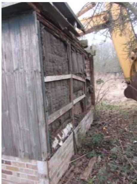
Foto 13: Gebäude 5, Seitenansicht, Verblendung defekt, Spalten und Nischen vorhanden
