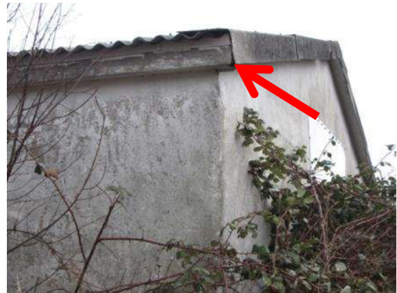
Foto 2: Gebäude 2: wie Gebäude 1, Spalten vorhanden (s. Pfeil)
