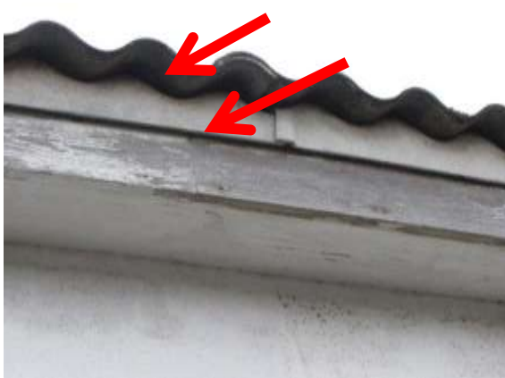
Foto 3: Gebäude 1 und 2: Dachüberstand mit Holzverkleidung u. Eternitleiste, Spalten vorhanden (s. Pfeile)
