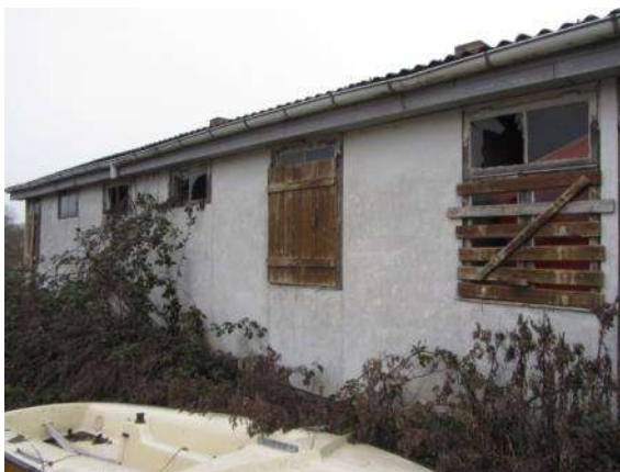
Foto 9: Gebäude 4, z.T. provisorisch zum Wohnen eingerichtet, aktuell nicht bewohnt, Fenster z.T. defekt oder verbrettert, Spalten und Nischen vorhanden
