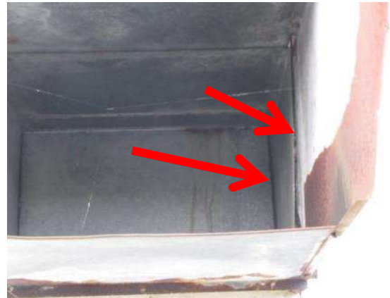
Foto 4: Gebäude 1 und 2: Blick in einen verschlossenen Lüftungskasten (Lage wie in Foto 1), Spalten vorhanden (s. Pfeile)
