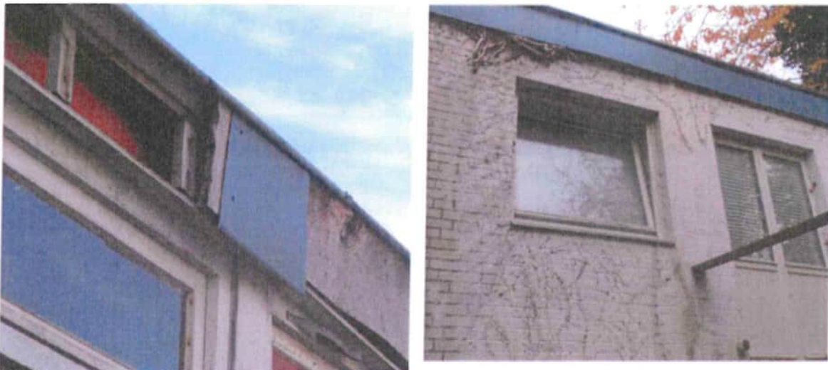
Abbildung 9: Spalten an Werkstattgebäude und leerstehendem Wohnhaus
