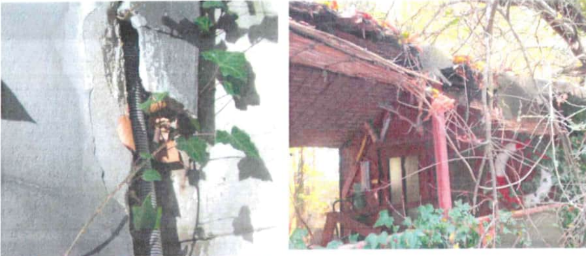
Abbildung 10: Spalten an Gartenhäusern
